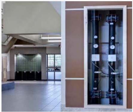
شكل (٢٦) حساسات وأجهزة القياس الخاصة بمنظومة الطاقة الحرارية الأرضية. (المصدر: CEFPI, 2012)
